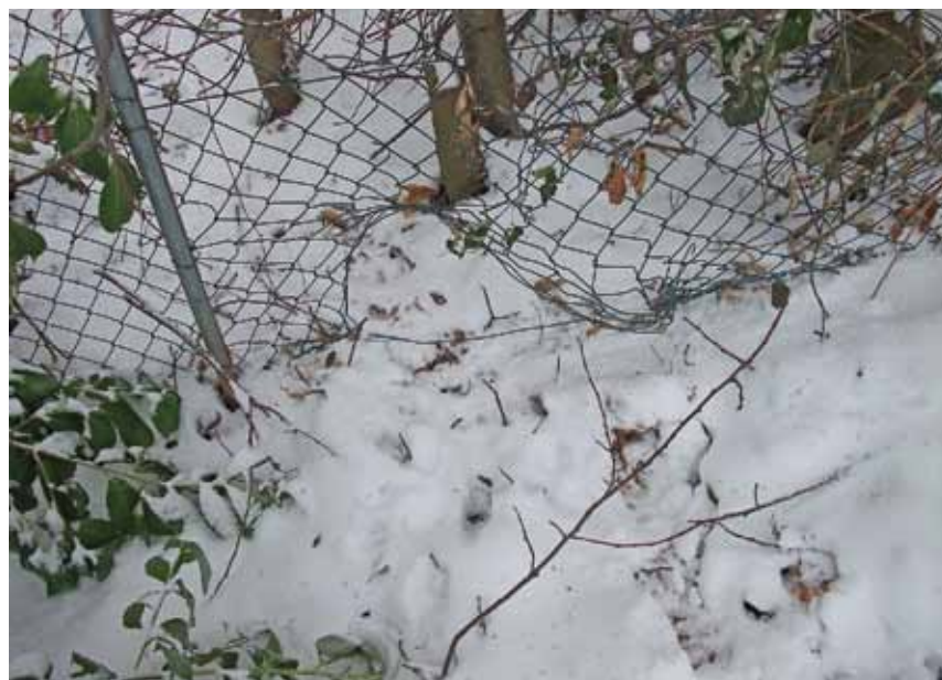
Ein hoher Wildzaun schützt gegen Hasen, Rehe und Wildschweine, sofern er stabil aufgebaut ist. Immer wieder wird er aber unterwühlt oder aufgedrückt. Im Winter verraten die Fährten, wo diese Leckagen sind. Eine Reparatur mit Baustahlmatten ist hier anzuraten, da die Tiere oft wieder die notdürftig geflickten Stellen aufbrechen. Fotos: Gerd Götz
