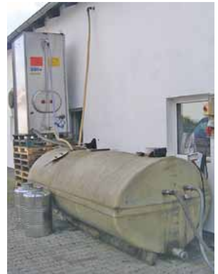
Kühlturm zum Kühlen von Wein.
