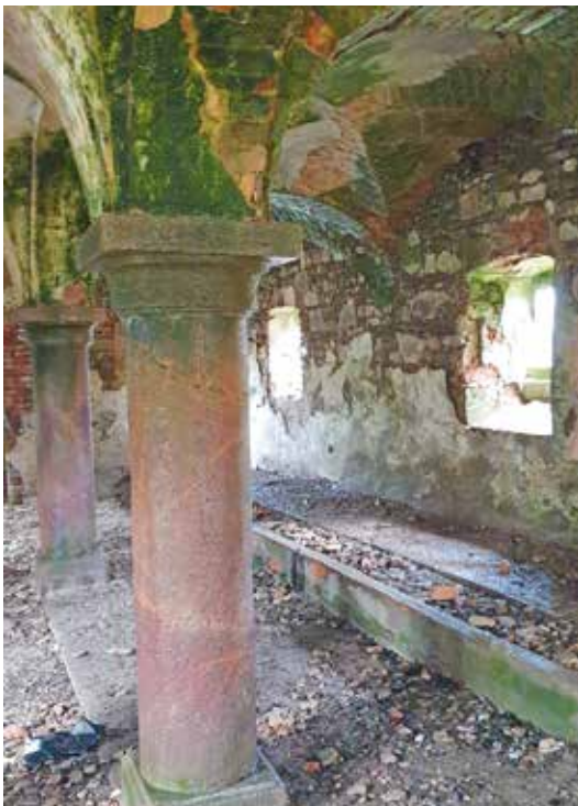
Ein alter Gewölbestall im Altenburger Land wartet auf Instandsetzung.
