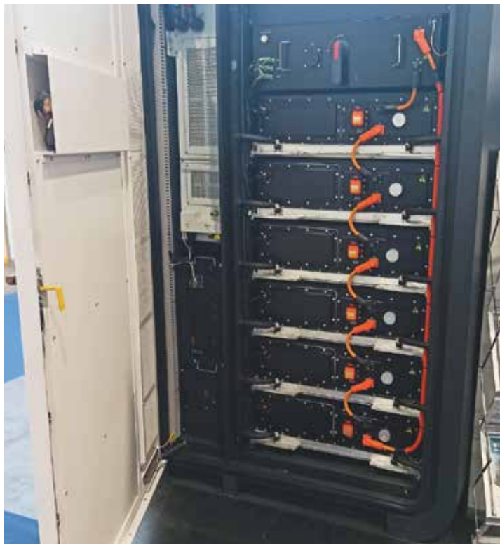
Die Nutzung von Akkus bietet sich in Kombination mit einer PV-Anlage an. Er dient dazu, in der Nacht Strom zur Verfügung zu stellen, bis die PV-Anlage wieder Strom erzeugt. Foto: Wahl
